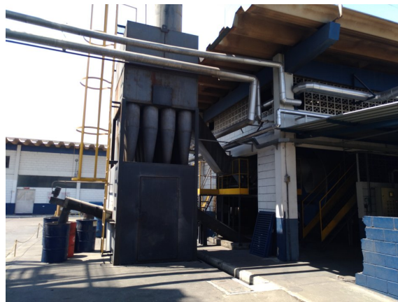
Foto 06. Sistema de tratamento de emissões atmosféricas da caldeira a lenha
