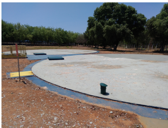
Foto 09. Reservatórios de água.
