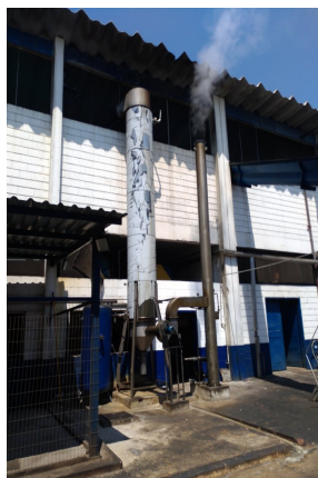
Foto 07. Lavador de gases da graxaria.
