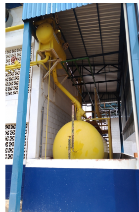
Foto 12. Tanque de amônia.
