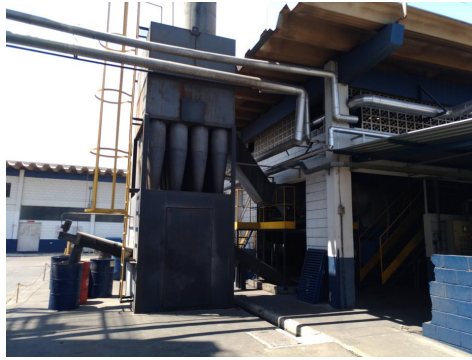
Foto 06. Sistema de tratamento de emissões atmosféricas da caldeira a lenha
