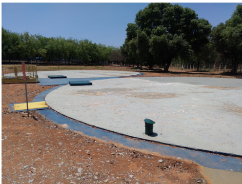
Foto 09. Reservatórios de água.
