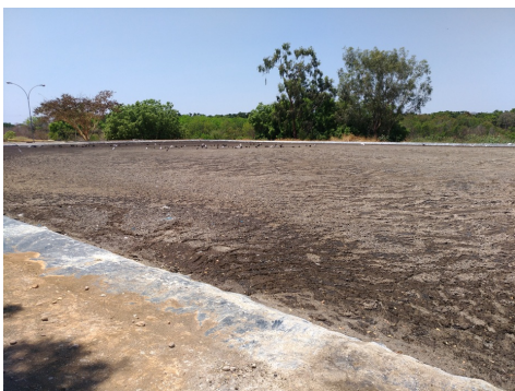
Foto 13. Lagoa aeróbica com material
