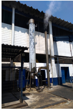
Foto 07. Lavador de gases da graxaria.
