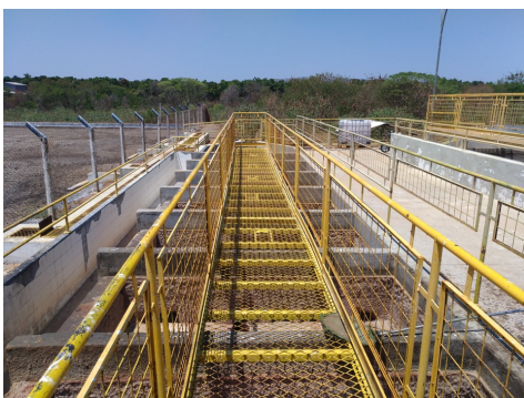
Foto 11. Decantadores da linha vermelha.
