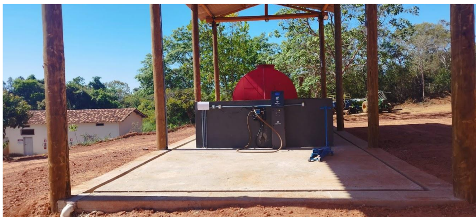
Ponto de Abastecimento na Faz. Caiçara. O tanque, com capacidade menor que 15m 3 , está em área estanque. A pista de abastecimento com piso impermeável e canaletas tem drenagem para caixa SAO.
