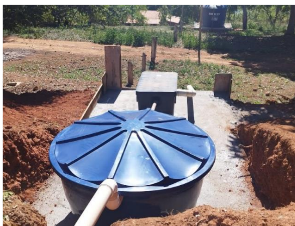
Caixa SAO que recebe a drenagem da pista do PA e do piso da oficina. Foi instalada uma caixa d'água para reter sedimentos e reduzir a velocidade do escoamento, preservando a caixa SAO e garantindo eficiência do sistema
