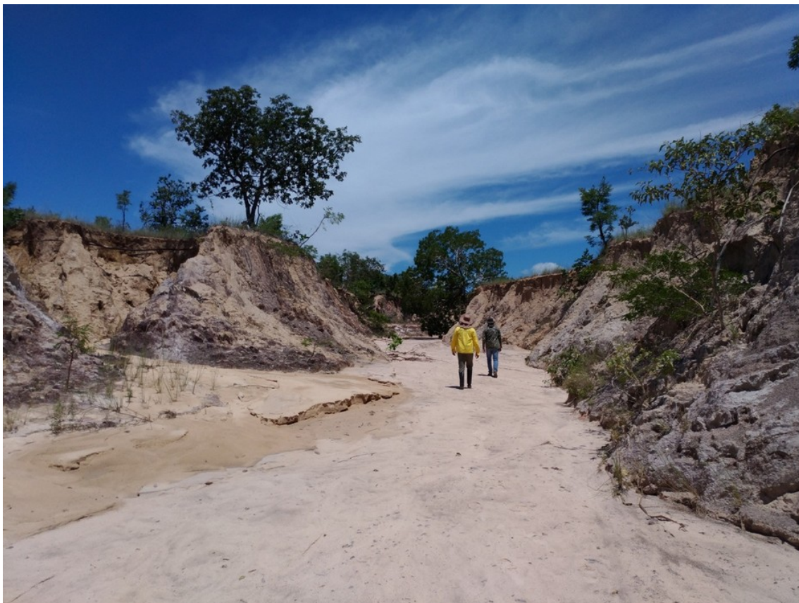
Imagem 03 – Voçoroca na reserva legal, coordenadas UTM 23 K X486894.54 m E / Y 8120688.09 m S.
