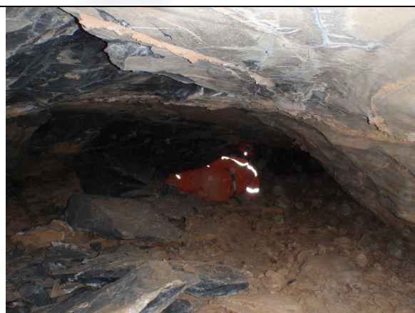
Foto 16. Fragmentos de rocha descolados do teto na região proximal à entrada da gruta Mata Grande II.
