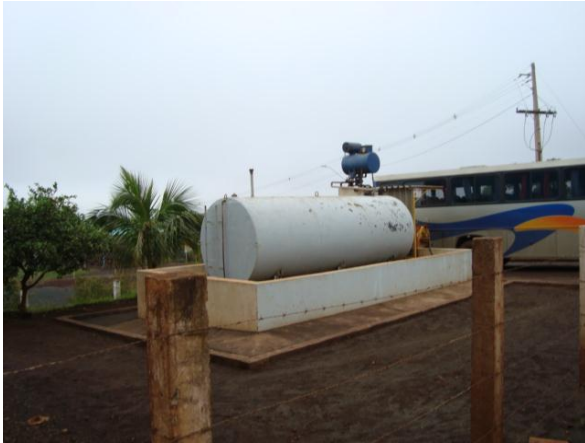
Foto 07. Tanque de abastecimento aéreo.
