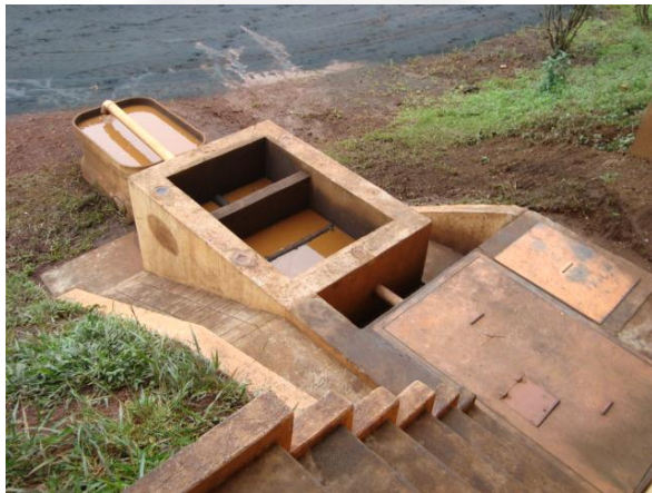
Foto 15. Caixa separadora de água e óleo
