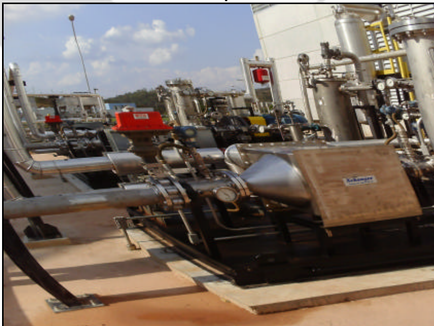
Foto 02: Vista do sistema de tratamento do biogás (Area externa da PCT)
