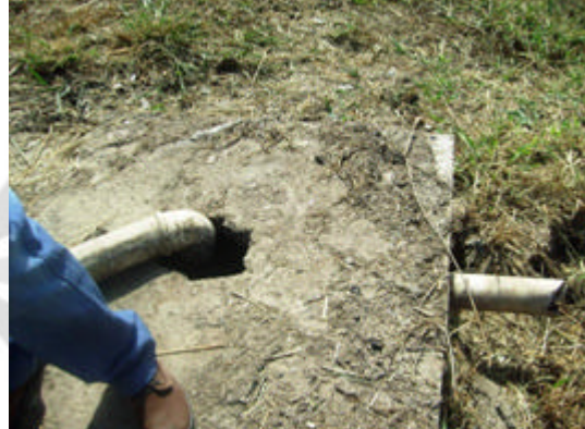
Foto 10. Caixa de passagem com trinca – ASMAC.
