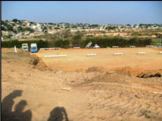
Foto 17. Area desmatada, sem autorização estadual, para construção de novo galpão.
