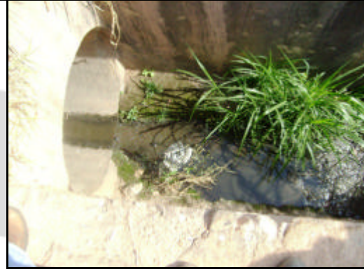
Foto 02. Esgoto em rede de água pluvial.
