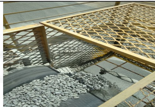
Foto 04. Aspersão de água na correia, saída do britador.
