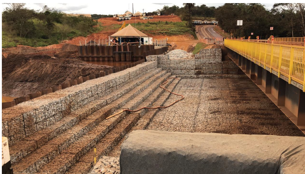
Figura 14: Cortina Metálica EP-01 para contenção de rejeitos - colchão Reno e muro de gabião. (Fonte: Vale - Plano de Manejo de Rejeitos. julho/2022-1 – ID 50616029 ).
