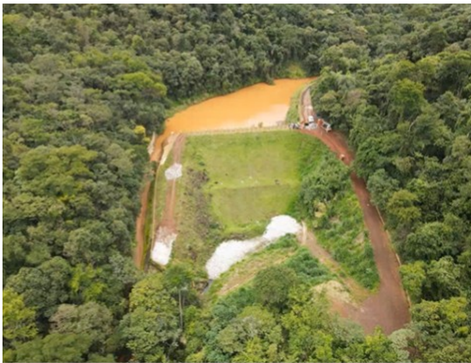
Figura 42: Barragem Menezes I, destacando a conclusão do alteamento da parede do canal extravasor). (Fonte: Sessão Técnica MP-MG/AECOM, jan/2023).
