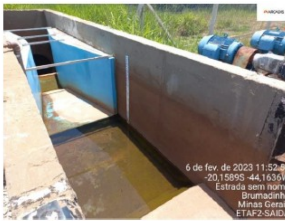
Ponto de coleta de efluente ETAF2-Saída (fev/23).
