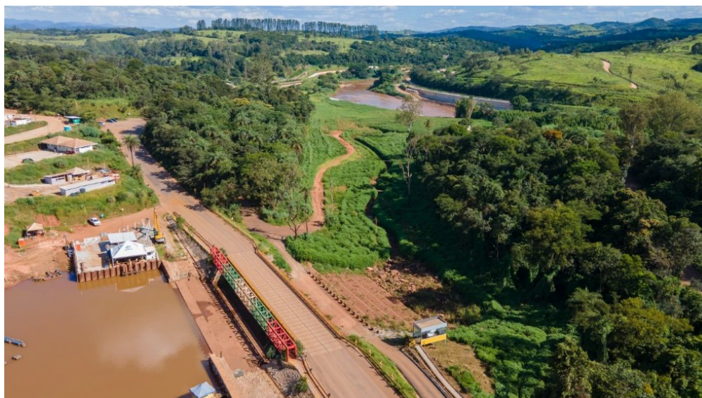
Figura 32: Local da recuperação do ribeirão Ferro-Carvão no Marco Zero. (Fonte: Vale, IC nov. 2021). Em janeiro de 2022 houve um grande volume de chuva na região, ocasionando significativo aumento no nível e na vazão dos cursos hídricos, gerando acúmulo de sedimentos / rejeito, inclusive na área do Marco Zero. Como consequência, a área da foto foi descaracterizada, resultando em ações de recuperação.
