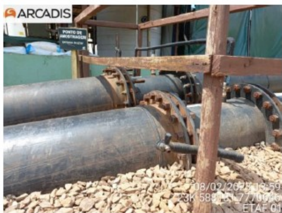
Ponto de coleta de efluente ETAF1-Entrada (fev/23).
