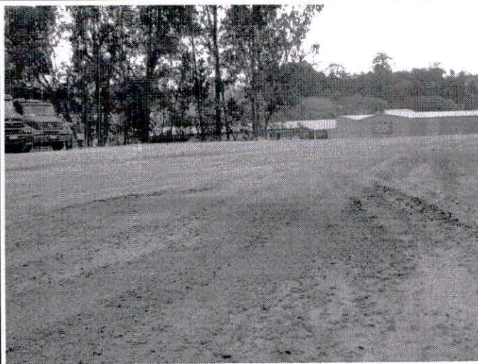
Pátio de carregamento de brita sem asfaltamento
