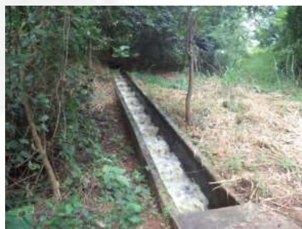
Ponto de lançamento de efluentes - Ribeirão Tronqueiras (coordenadas 19°44'15,9"/50°14'8,4")
