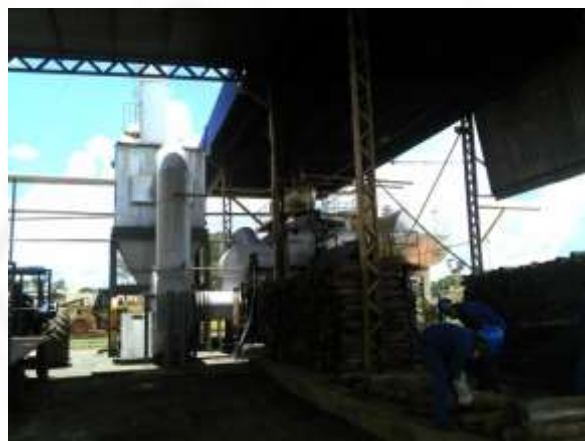
Caldeira a biomassa com sistema multiciclone.
