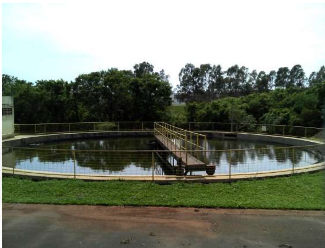
Tanque de decantação
