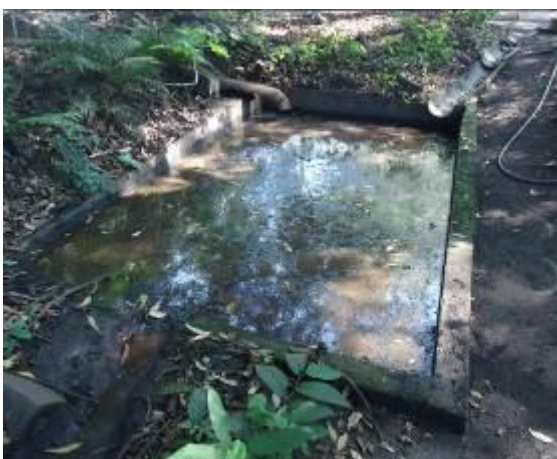
Foto 09. Tanque de decantação de efluentes pluviais.
