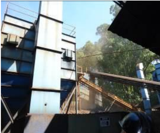
Foto 05. Filtro de mangas para efluentes gerados no peneiramento e manuseio de matérias primas.
