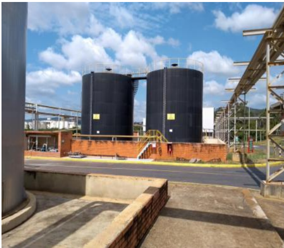
Foto 23 - Tanques óleo caldeiras
