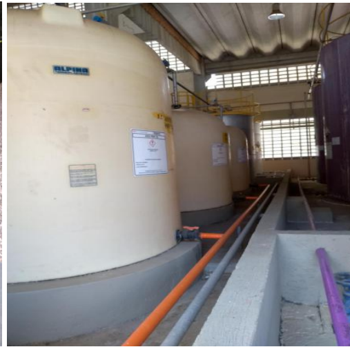
Foto 22 - Tanques de insumos
