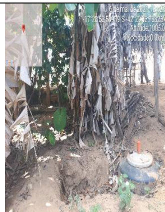
Figura 6. Biodigester implantado na casa do caseiro
