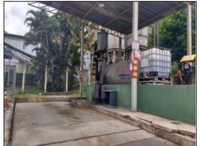
Foto 08 – Ponto de abastecimento do empreendimento (foto apresentada pelo empreendedor no RADA). Observa-se que o empreendimento possui um tanque metálico maior, com capacidade de 14.000 L (Diesel S500) e um tanque plástico menor, este com capacidade de 3.000 L (Diesel S10).
