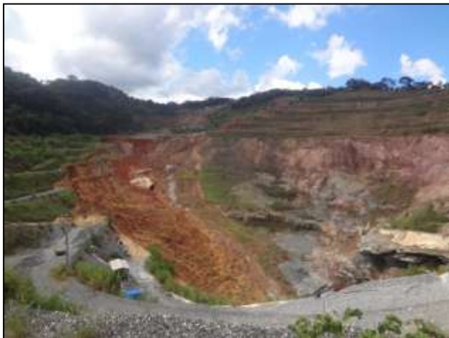
Foto 01 – Vista da lavra a céu aberto licenciada via LOC n.º 007/2015, que se encontrava paralisada no momento da vistoria. Observa-se o desmoronamento parcial de taludes em virtude das chuvas que atingiram a região no início do ano de 2020.
