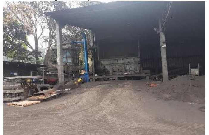
Foto 06. Filtro de mangas
