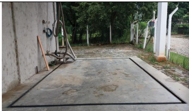
Figura 05: Área de descarga de produtos químicos a granel com sistema de calha para conter possíveis derramamentos.
