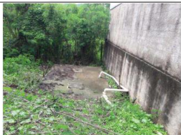
Figura 07: Estação de tratamento de efluentes líquidos sanitários 1 (ETES)
