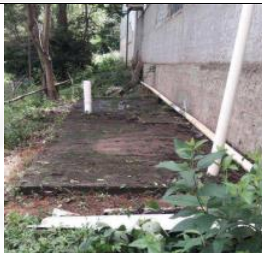
Figura 08: Estação de tratamento de efluentes líquidos sanitários 2 (ETES)
