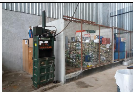
Figura 02: Depósito Temporário de Resíduos (DTR)
