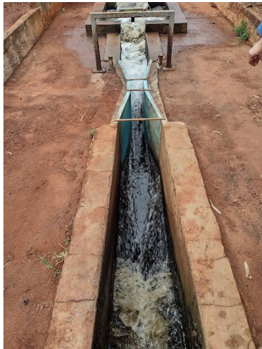
Calha Parshal/ saída da ETE
