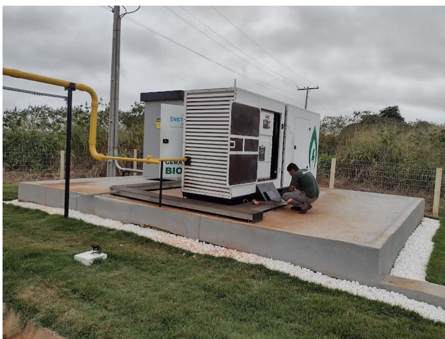
Foto vistoria: Motor estacionário, queima de gás metano/ geração de energia
