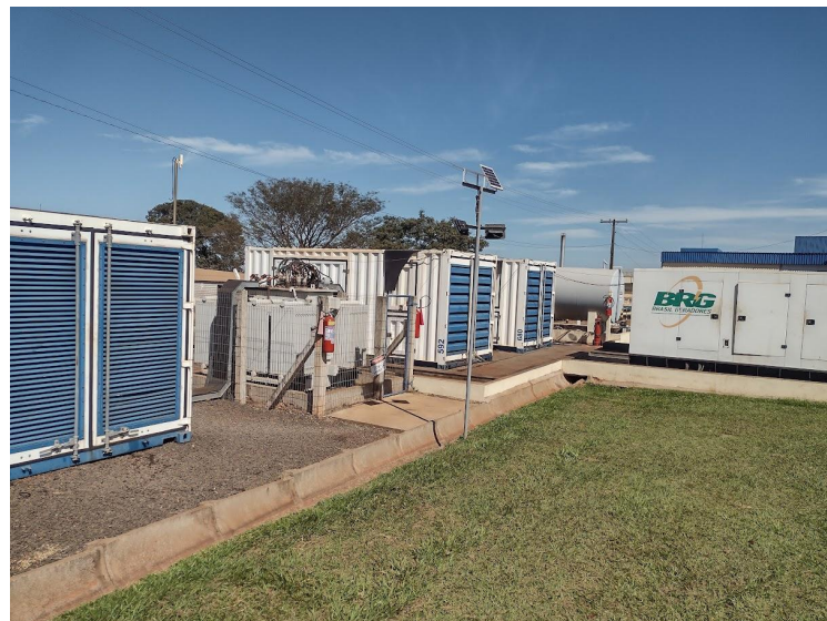
Foto vistoria: Detalhe dos grupos geradores
