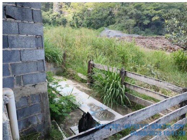
Foto 06. Caixa Separadora de Água e Óleo (CSAO).
