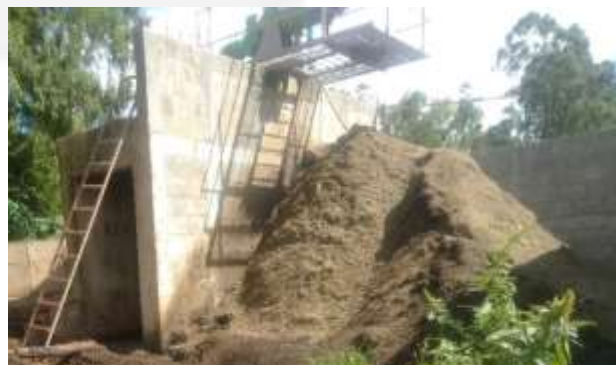
Filtro separador das partes sólidas e líquidas do dejetos suíno
