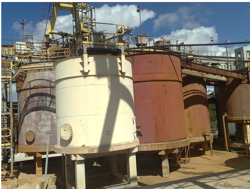
Foto03: processo de neutralização na planta metalúrgica(em funcionamento)
