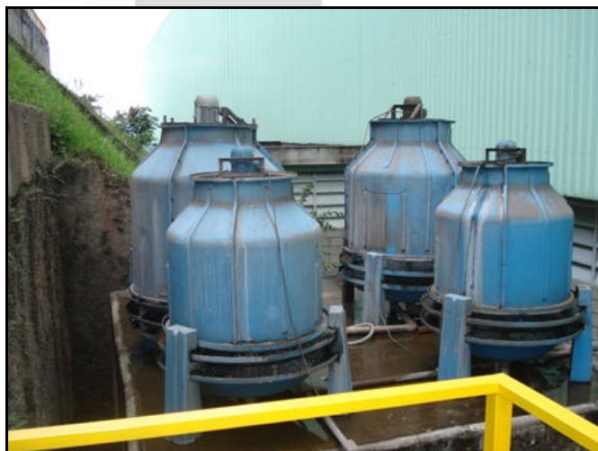
Foto 11. Torre de resfriamento (Unidades 1 e 2).
