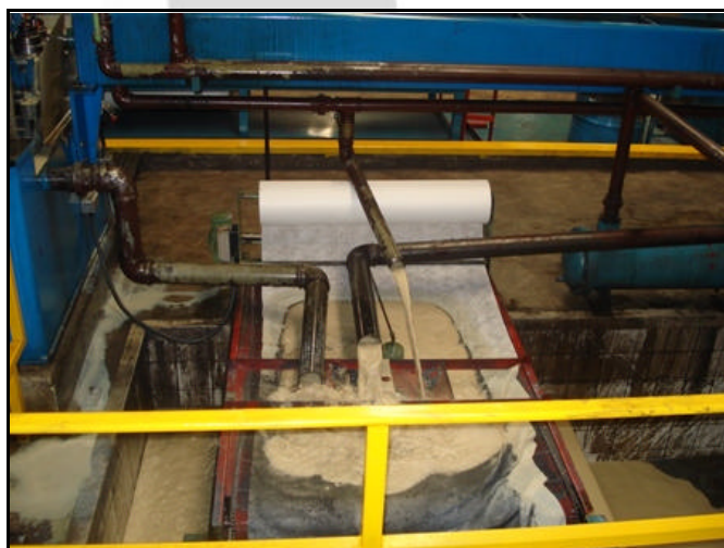
Foto 03. Filtragem da água recirculada.
