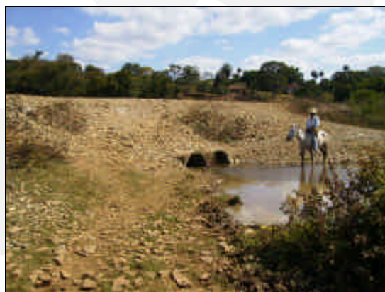
Foto 06. Vista do sistema de drenagem do dique e morador local utilizando a área para passagem.
