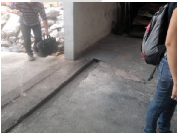
Foto 3: Canaleta de drenagem e caixa de coleta para eventuais derrames de líquidos. Piso de cimento.
