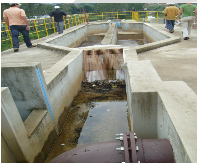
Foto 01- Tratamento preliminar: grades grossas, limpeza manual
