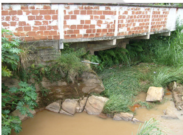
Foto 15: Ponto de lançamento de esgoto in natura no córrego Caeté.
