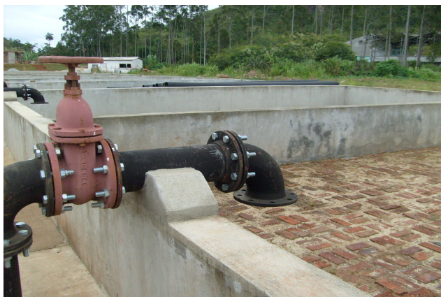
Foto 11: Leito de secagem, bem como tubulação de disposição do lodo no mesmo.
