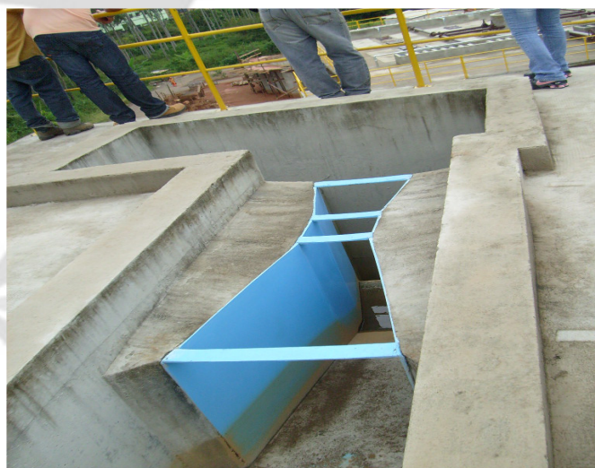
Foto 02: Tratamento preliminar: Calha Parshall
