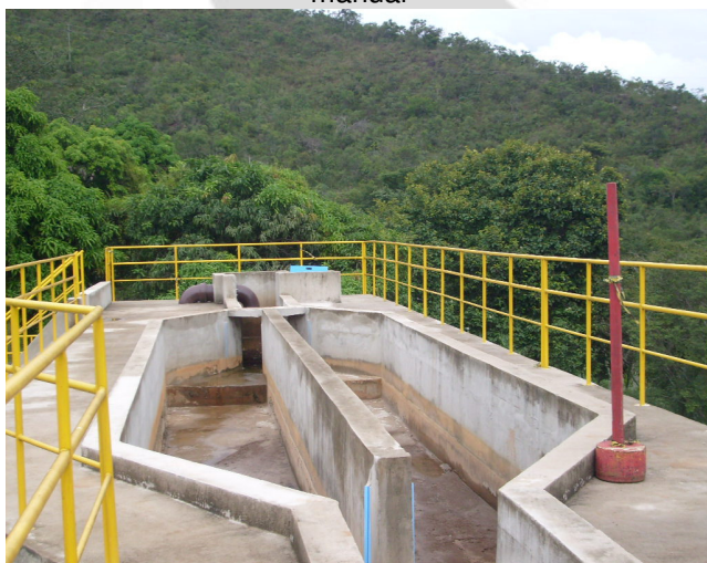
Foto 03: Tratamento Preliminar: Desarenadores
