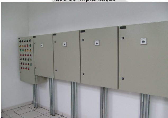
Foto 09: Casa de máquinas
