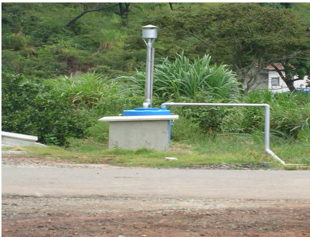
Foto 05: Queimador de gases do reator UASB
