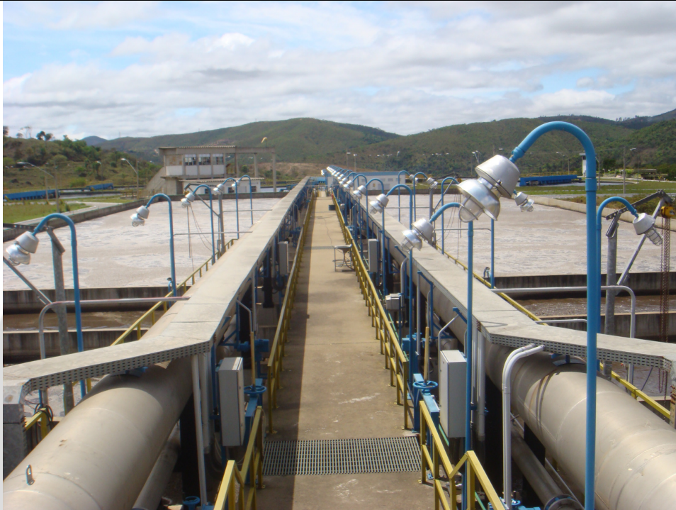
Foto 02: Vista dos decantadores primários em operação
