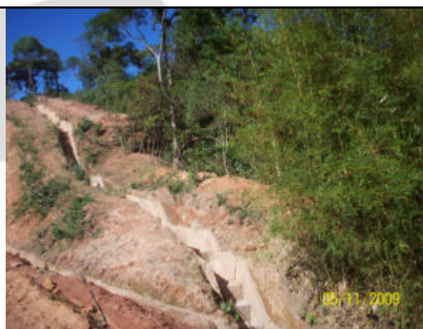
Foto 16: Sistema de drenagem do antigo lixão.
