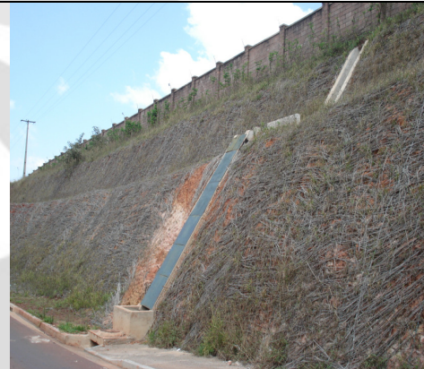
Foto 16 – Sistema de drenagem e contenção de talude às margens da BR 356
