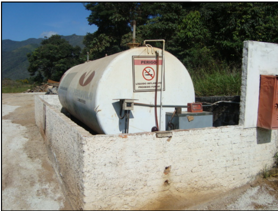
Foto 15. Tanque de abastecimento aéreo necessitando de adequações conforme normas específicas.
