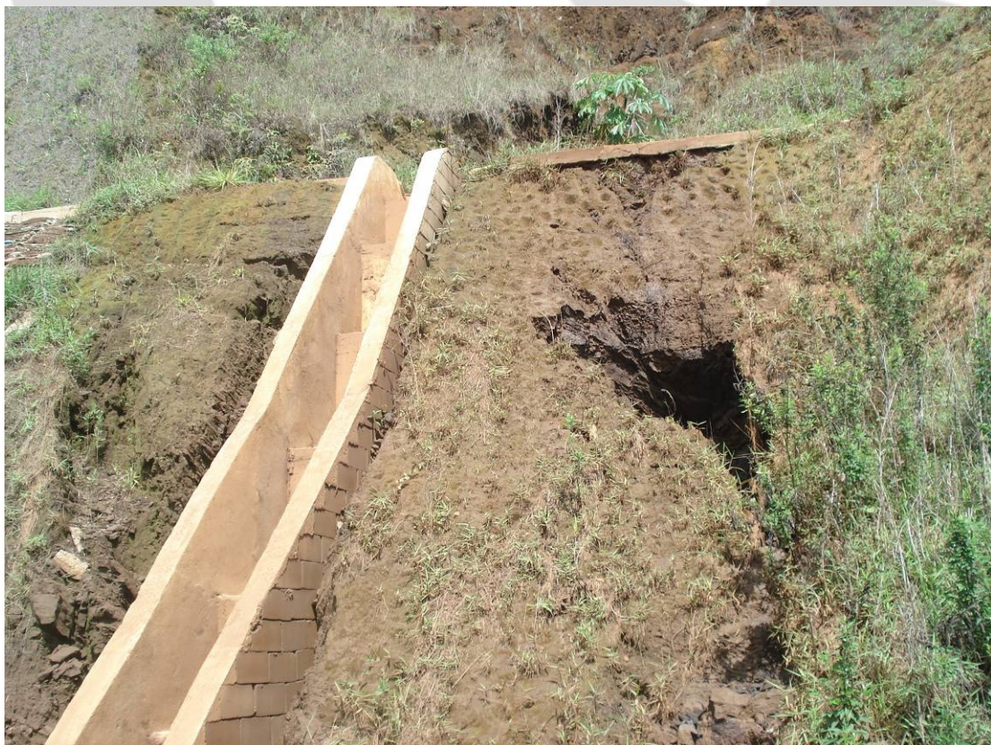
Foto 05: Sistema de drenagem pluvial na área do empreendimento Portal SUL
