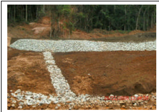
Ilustração 5: Dreno de Fundo Fonte: Relatório de atendimento de condicionantes
