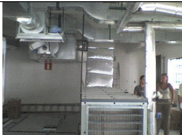
Foto 11: Sistema de Exaustão da nova área de manipulação de medicamentos sólidos.
