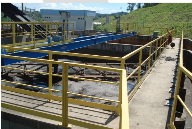
Foto 03: Tratamento Preliminar Desarenadores
