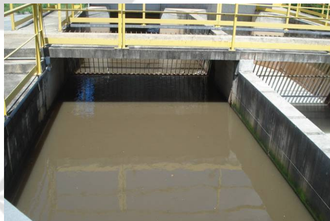
Foto 02: Tratamento preliminar grades grossas, limpeza manual
