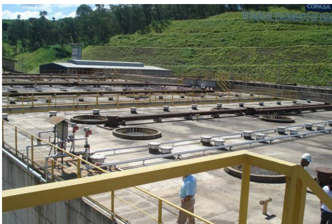
Foto 05: Tratamento primário, reatores UASB
