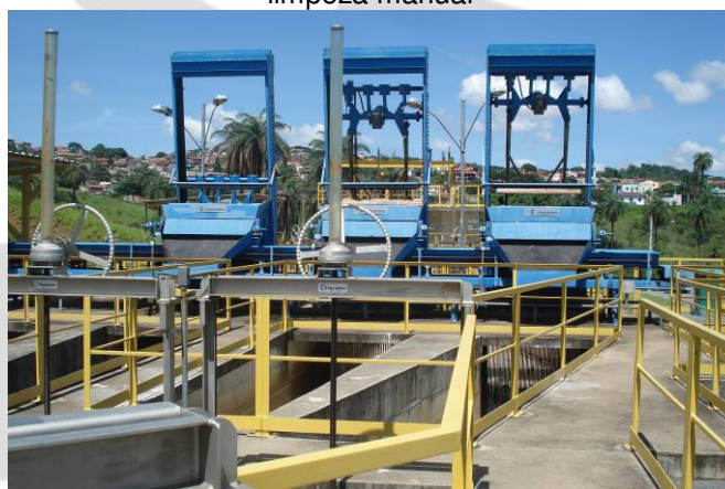
Foto 04: tratamento preliminar grades finas de limpeza mecânica
