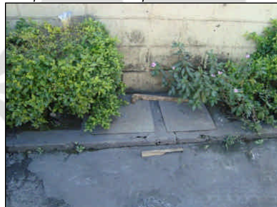
Foto 04. Caixas de decantação.
