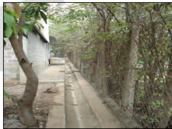
Foto 06. Sistema de drenagem pluvial.
