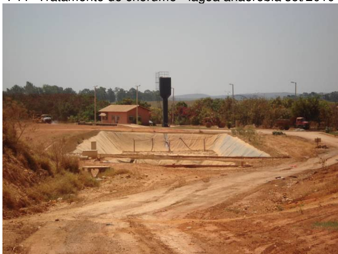
F13- Tratamento do chorume - lagoa facultativa não concluída. Set/2010
