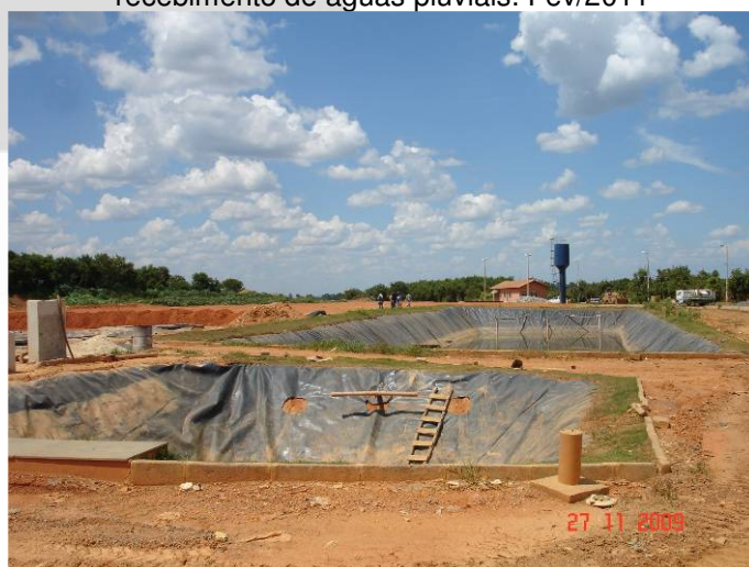
F10- Tratamento do chorume – lagoas não concluídas em Nov/2009
