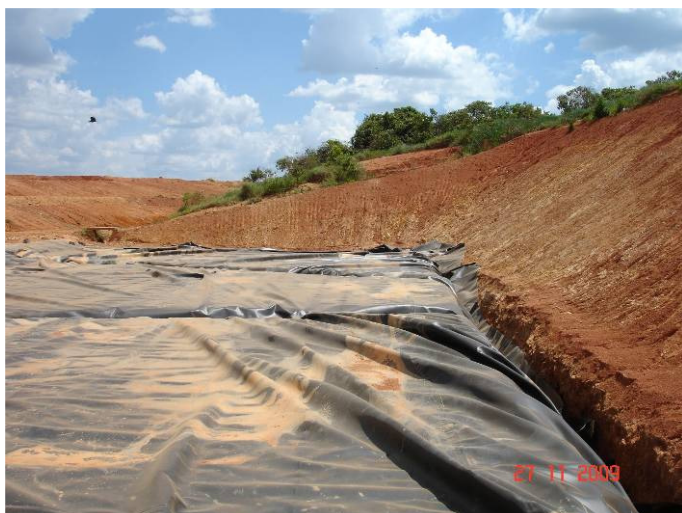
F5 - Primeira plataforma do aterro – sem PEAD nos taludes, área da base apenas parcialmente terraplanada e PEAD da base implantado inadequadamente. Nov/2009
