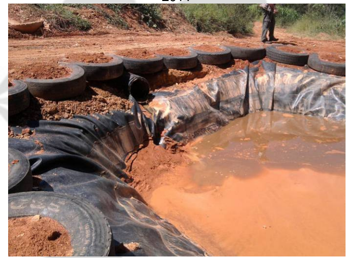
F8 - Vala de acumulação de chorume do aterro controlado – revestimento em PEAD com ancoragem inadequada e recebimento de águas pluviais. Fev/2011
