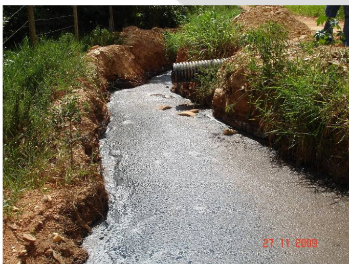
F9- Vala de acumulação de chorume do aterro controlado, lançamento direto no solo. Nov/2009
