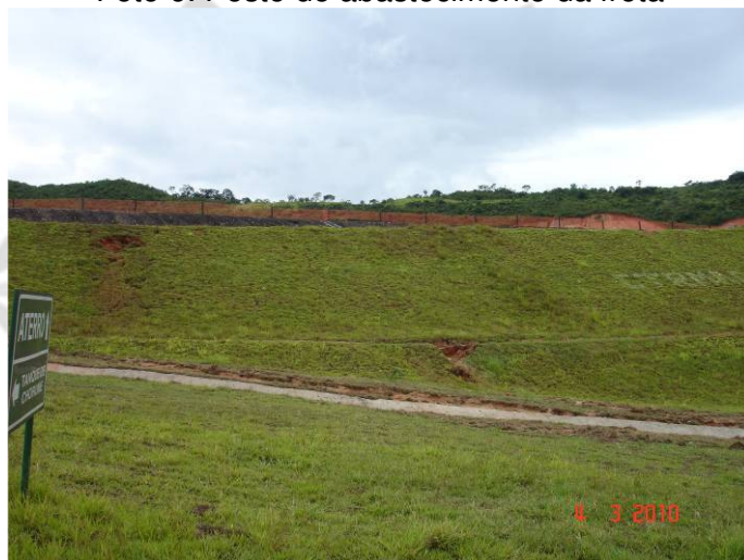
Foto 8: Dique de contenção
