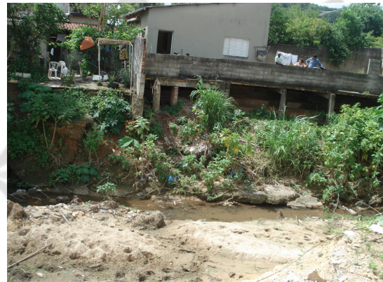
Foto 8: Casas em APP à montante da intervenção – leito original – dez/2010
