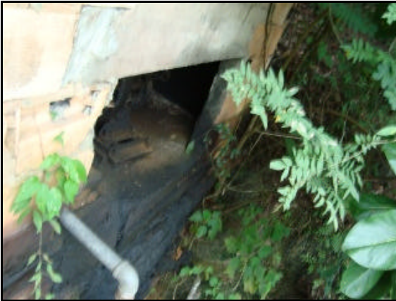
Foto 27. Propriedade vizinha – Casa de bomba (observar presença de óleo)
