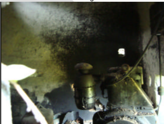
Foto 25. Propriedade vizinha – Interior da casa de bomba (observar presença de óleo)
