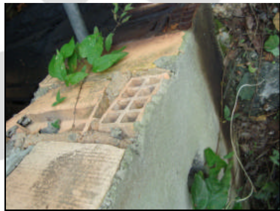
Foto 26. Propriedade vizinha – Casa de bomba (observar presença de óleo)
