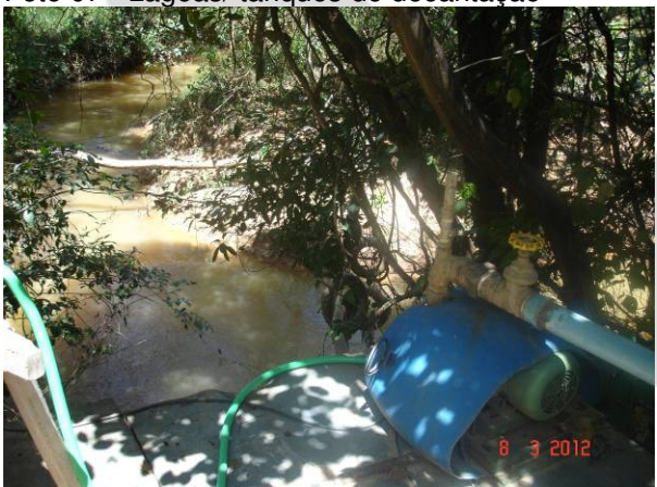
Foto 09 - Captação no rio verde para reabastecimento do sistema
