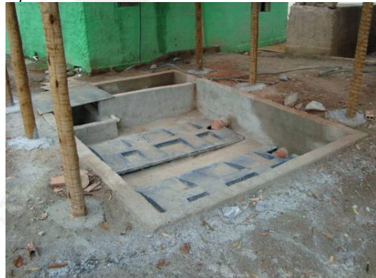
Foto 04. Sistema de tratamento de efluentes oleosos.
