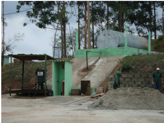
Foto 03. Sistema de contenção instalado na área de abastecimento de combustível.
