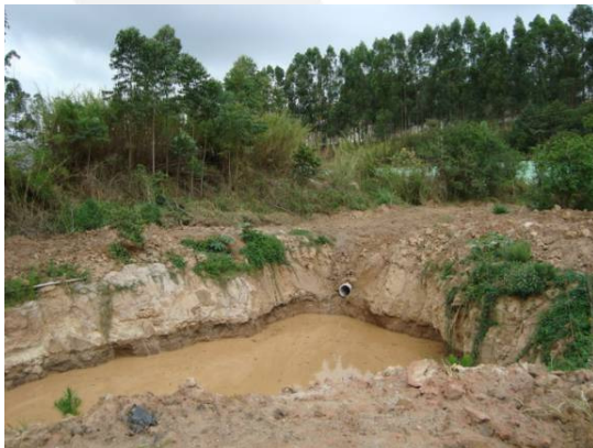
Foto 05. Sistema de drenagem da mina.
