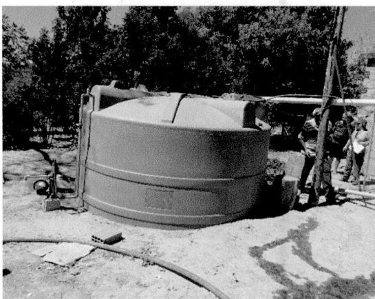
Foto 21. Caixa de captação de água
