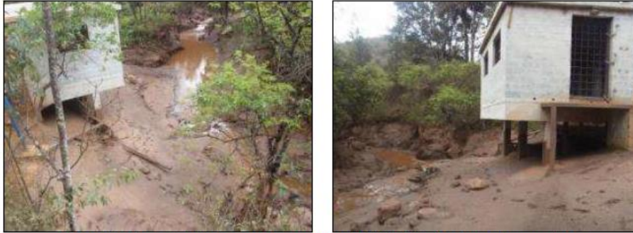
Fotos 3.7.1-8 e 3.7.1-9 - data do registro 17/09/2014. Vista da área onde o Condomínio Villa Bella faz captação de água. Nota-se que o mesmo fenômeno de decapagem ou lavagem também ocorreu neste trecho do Ribeirão do Silva.
