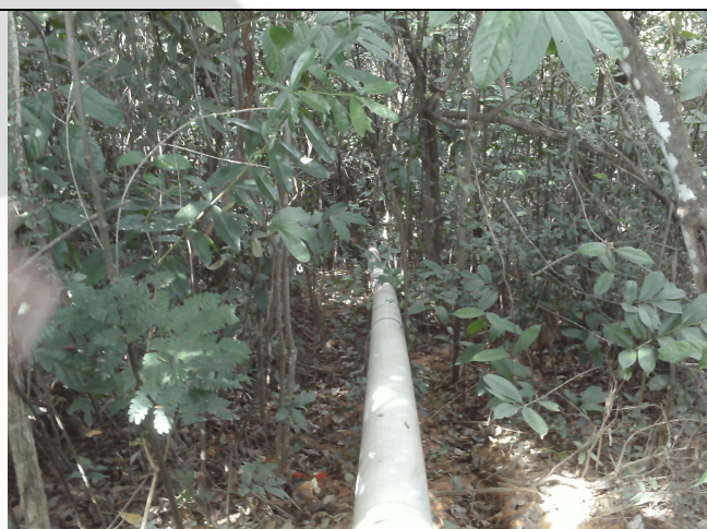
Foto 12: Tubulação que levará o efluente tratado ao córrego do tropeiro
