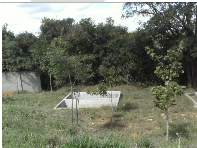
Foto 09: Leitos de secagem
