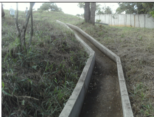
Foto 11: Canaleta para coleta e lançamento da água pluvial.
