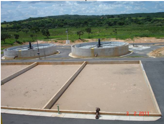
Foto 03: Leitões de Secagem e filtros biológicos ao fundo
