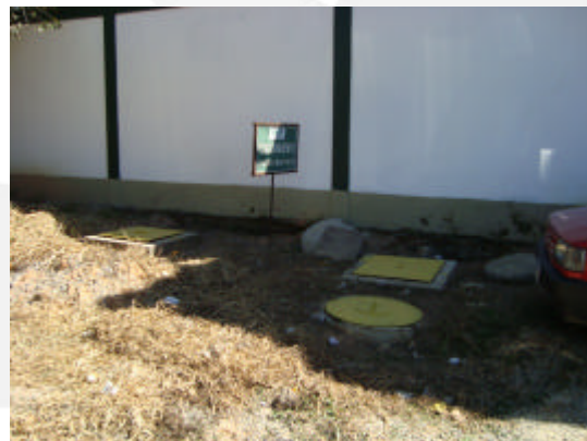
Foto 06. Sistema de tratamento de efluentes sanitários.
