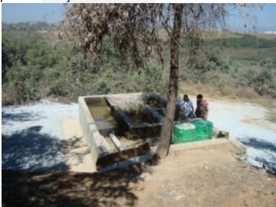
Foto 05. Sistema de separação de água e óleo ligado à oficina.
