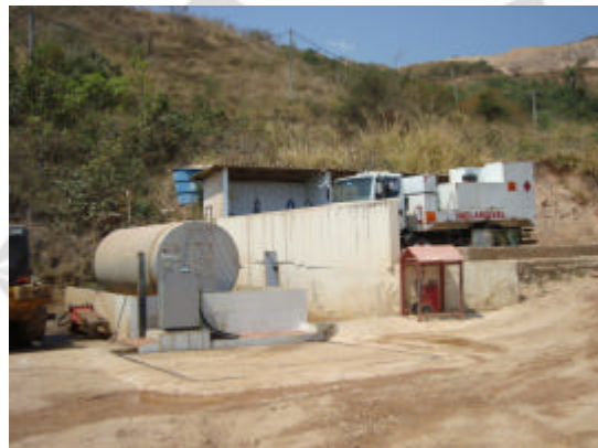
Foto 12. Sistema de armazenamento de combustível e outros com mecanismos de contenção contra vazamento.
