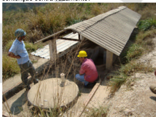
Foto 14. Sistema de efluente sanitário.
