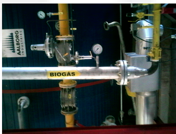
Foto 04: Caldeira com equipamento para reutilização do biogás
