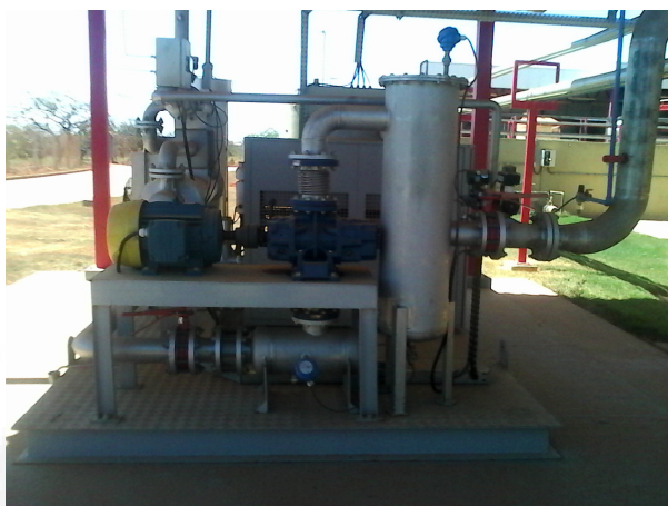
Foto 03: Planta de reaproveitamento de biogás
