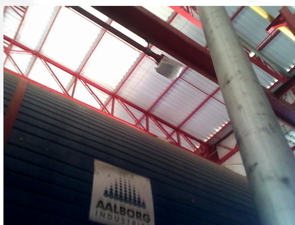
Foto 05: Detectores de vazamento de biogás instalado na caldeira
